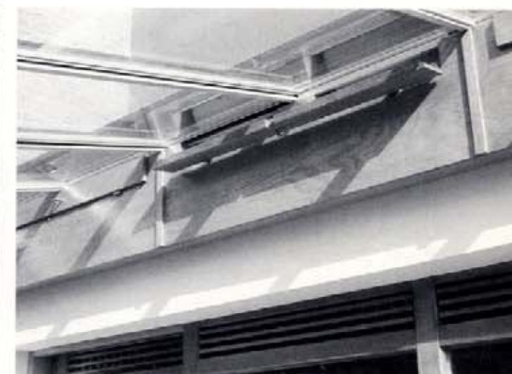
223 Über Lüftungsschlitze der Holzschiebefenster (unten im Foto) kann warme Luft nach innen in den Arbeitsraum geführt oder über die Dauerentlüftungsklappe (oben) nach außen abgeleitet werden.
